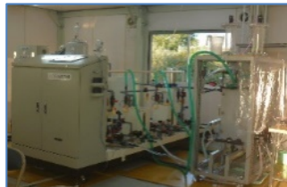
濃度差水素製造システムの 実証試験
